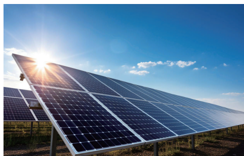
楚雄双柏干海资一期 200MW复合型光伏项目
